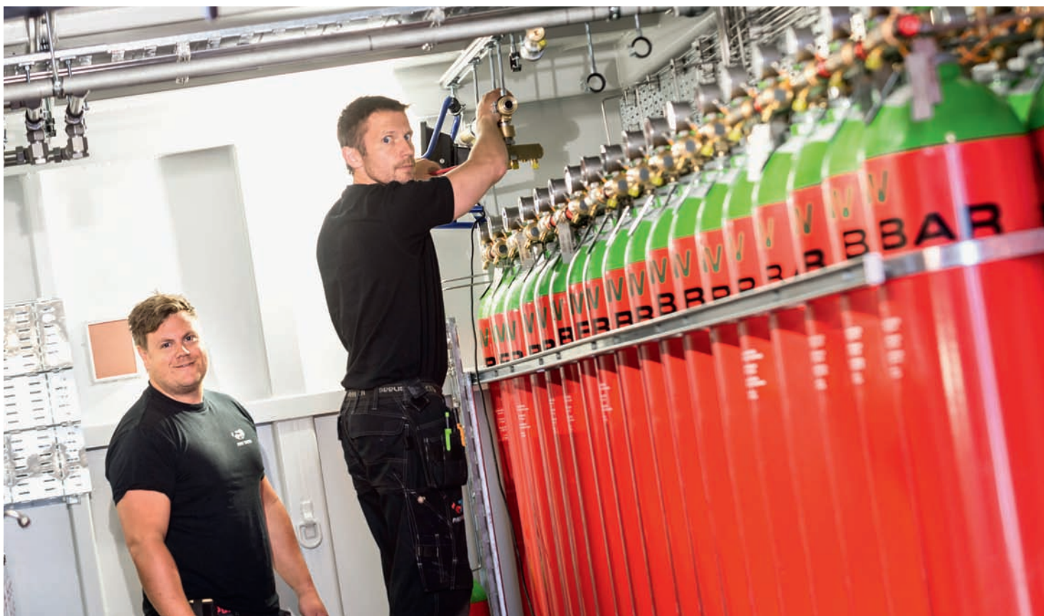
Inergen slokkeluft til faste anlegg slokker ved reduksjon av oksygennivået i rommet. Gassen er medisinsk sammensatt for å gi best mulig personsikkerhet. Inergen gir ingen sekundærskader og er helt ufarlig å puste inn. Inergen ble patentert i 1987.
