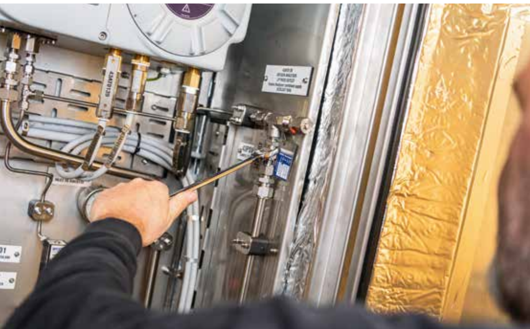
Holta & Håland-selskapet Process Control er godt i gang med leveransen av flere gassanalysekabinetter til Johan Castberg feltet.
