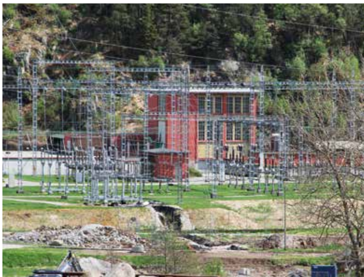
Tronsholen er en av 51 transformatorstasjoner i overordnet distribusjonsnett i Sør-Rogaland som transformerer spenning fra ett nivå til et annet. Foto: Lyse Elnett
